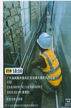
施工 1 标 3#支洞生活营地 厨房油水分离器出水口
